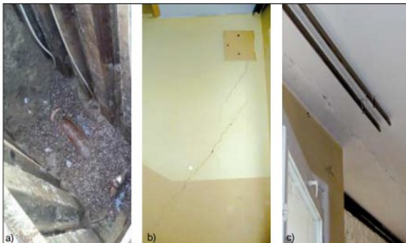
Fot. 3. Popękana ściana od wstrząsów i wibracji wywołanych przez zabijanie grodzic stalowych zabezpieczających głębokie wykop w trakcie robót drogowo-instalacyjnych: a) głęboki wykop, b) popękana ściana, c) pęknięty strop
