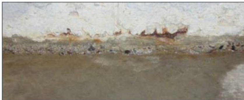
Fot. 4. Porowata dolna część ściany przepuszcza wodę
