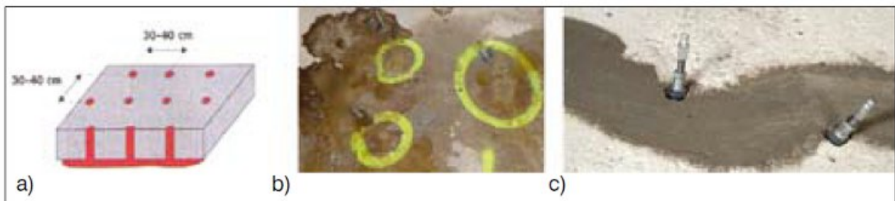
Rys. 8. Przykład uszczelniania płyty fundamentowej kurtynowo i powierzchniowo: a) typowe odległości między otworami iniekcyjnymi, b) przykład iniekcji powierzchniowej, c) iniekcja do rysy w posadzce, rysa powierzchniowo zamknięta, iniektory osadzone pod kątem 45^\circ
